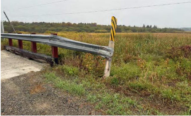
Guardrail Damage - NE
